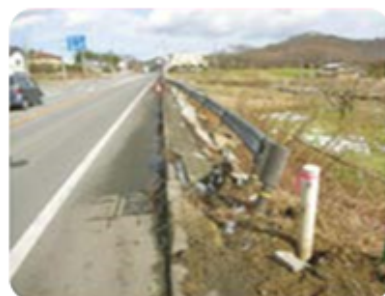
ガードレール・ 標識等の損傷
